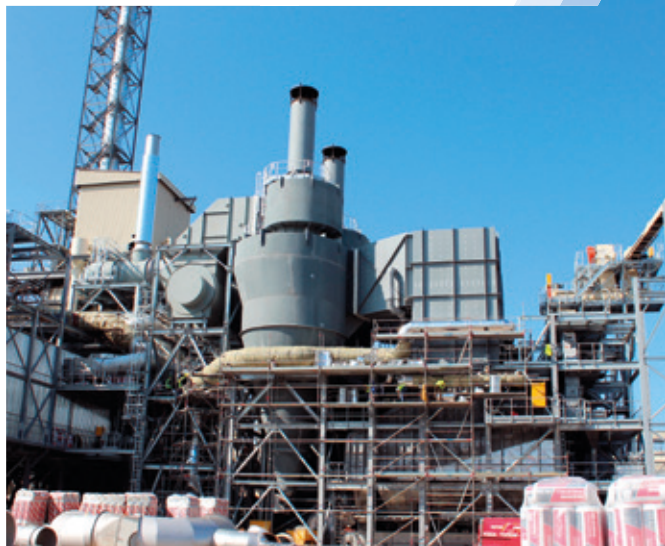
Pohled na nové filtrační zařízení v areálu jihlavského závodu Kronospan, jehož zkušební provoz by měl být zahájen v listopadu 2014. Foto: PSJ
